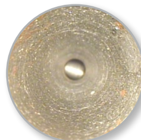
Ablagerungen im Rohr
